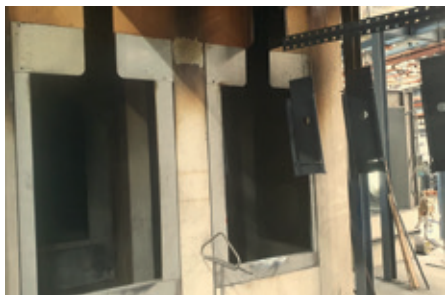
▲ Exemple d'installation avec un coût énergétique élevé par m 2
