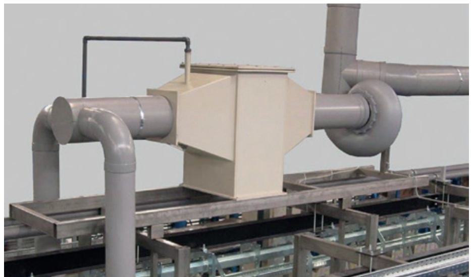
▲ Récepteurs de gouttes sur les zones de pulvérisation chauffées
