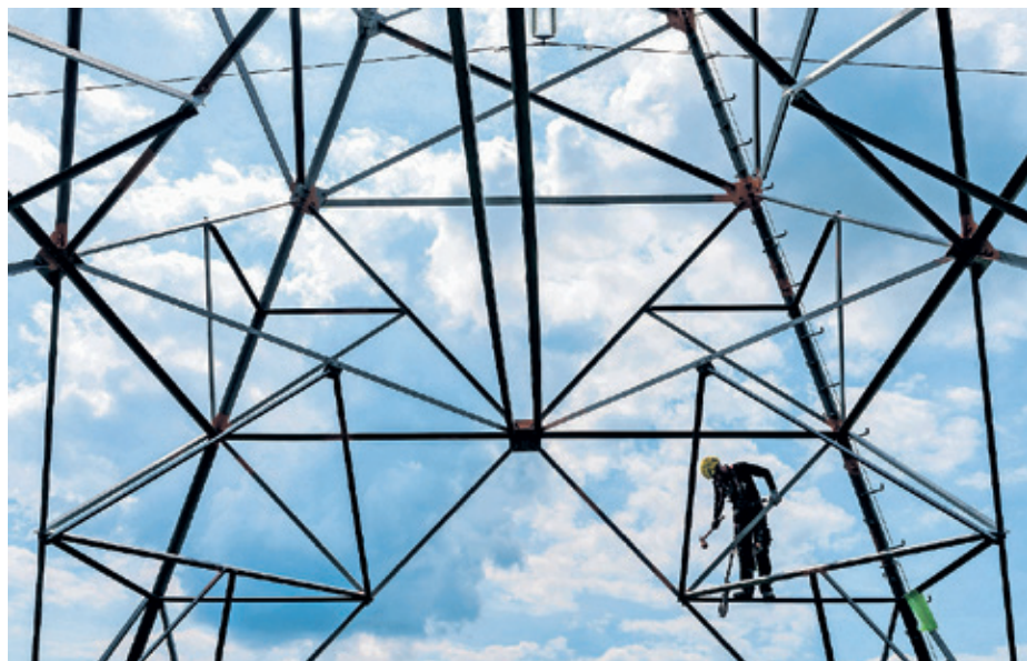
▲ De hoogspanningsmasten in Schijndel worden geschilderd
